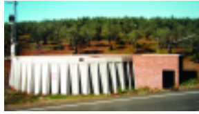
DEPÓSITO DE ABASTECIMIENTO SAN MARCOS CÁCERES
